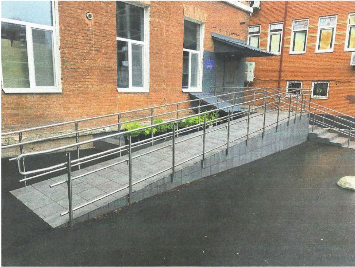
Фото1. Пандус на вході до будівлі для мало мобільних груп населення
